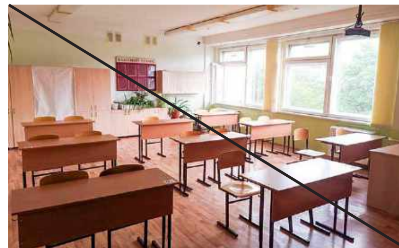
Плохо Линолеум под дерево
